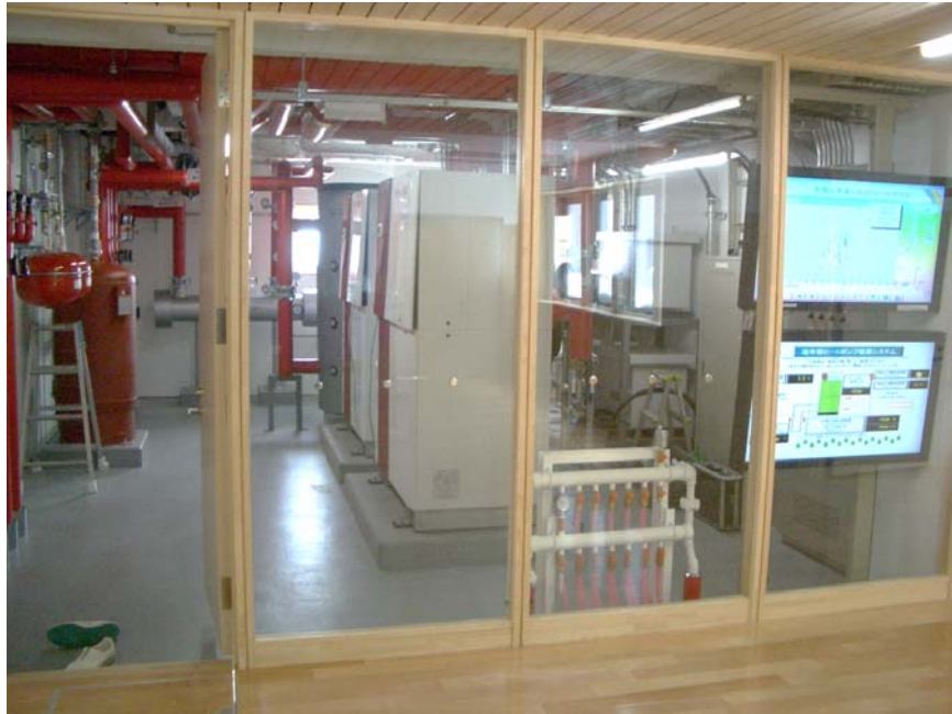
機械室のスケルトン化および稼働状況のグラフィック表示
