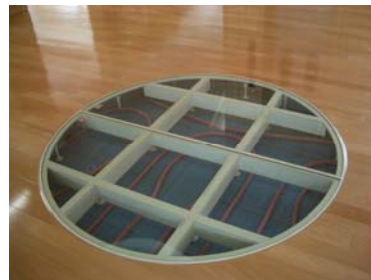
床暖房パイピング
