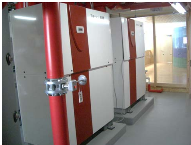
機械室内地中熱ヒートポンプ
